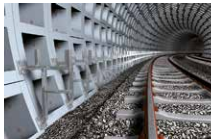
Installazioni in galleria
